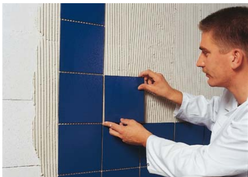
Fliesen direkt auf Porenbeton-Mauerwerk
